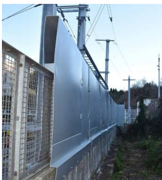
Chiasso, Isolation zwischen Schaltposten und Zaun
